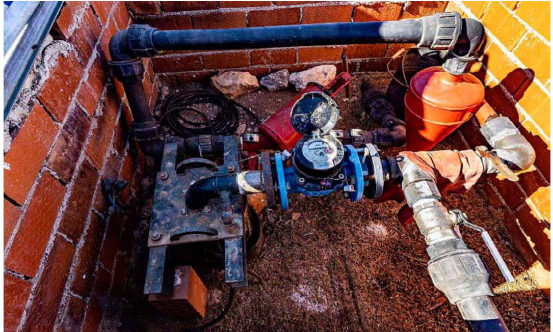
Un caudalímetro instalado en una explotación agraria de la provincia para el control del agua que se extrae de los pozos. / RUEDA VILLABERDE
