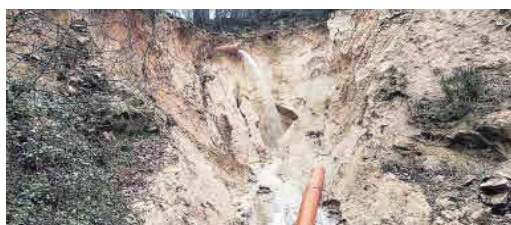
El tramo roto del colector del Valle del Jerte.
